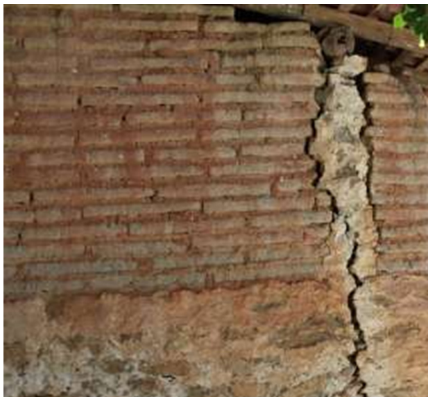
Fotografía 5 Vivienda afectada por los fenómenos naturales
